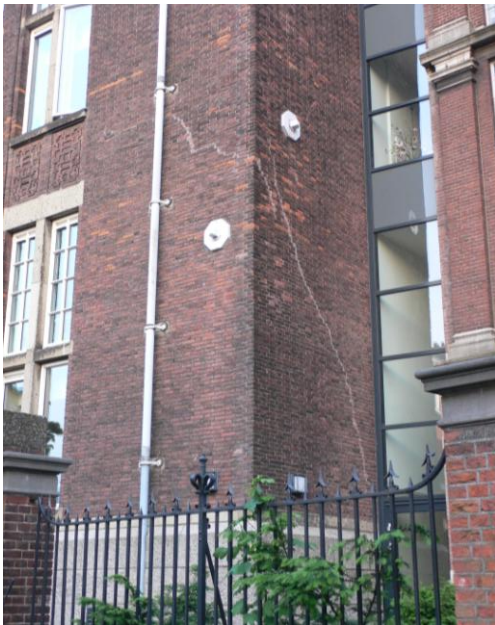
Fig. 6.1. Kleurverandering in de muur na herstel scheur
