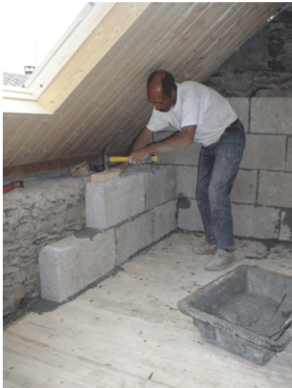
Pose de blocs de chanvre de 15 cm en isolation intérieure d'un mur en pierres
