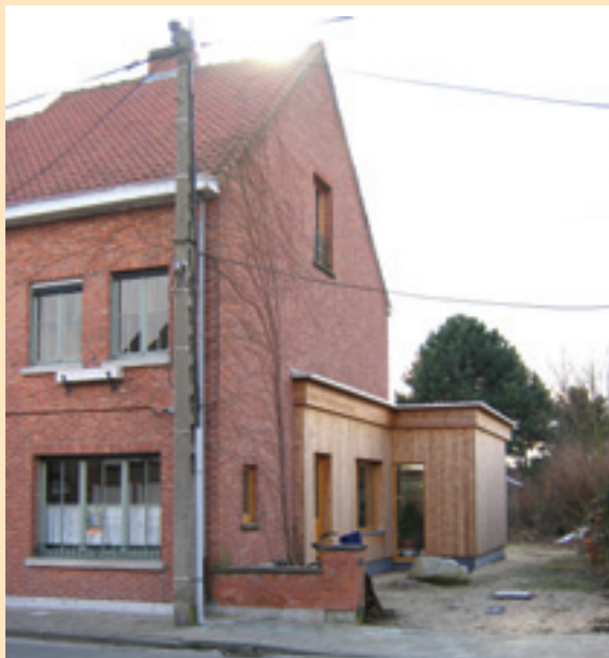
Achter de houten beplanking werd de bestaande muur extra geïsoleerd. Foto Vibe.
